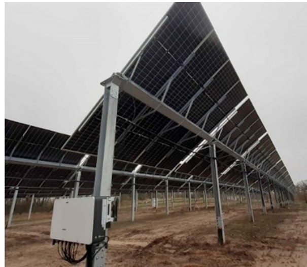
Einachsige nachgeführte Versuchsanlage am ZALF in Müncheberg.
